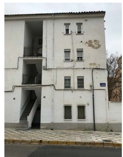
Fragmento de fachada a calle Burgos. La escalera abierta invade la acera.
